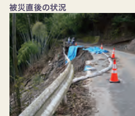
被災直後の状況
